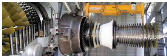
Turbina a gas ciclo combinato RPW 2°GT
