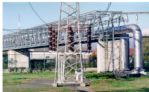
Tubazioni teleriscaldamento in uscita dalla Centrale.
