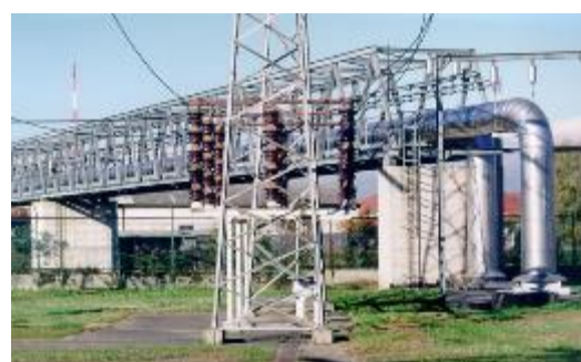
Tubazioni teleriscaldamento in uscita dalla Centrale.
