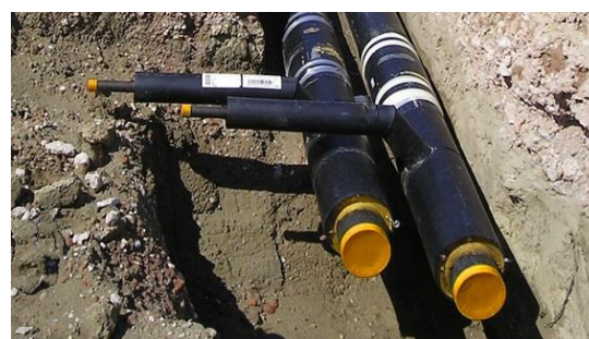
Tubazioni preisolate di teleriscaldamento.
