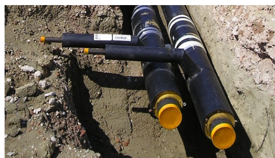
Tubazioni preisolate di teleriscaldamento.
