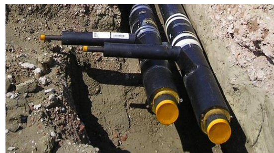
Tubazioni di teleriscaldamento preisolato.
