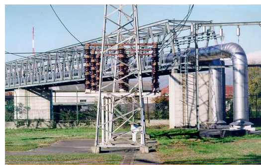
● Tubazioni teleriscaldamento in uscita dalla Centrale.
