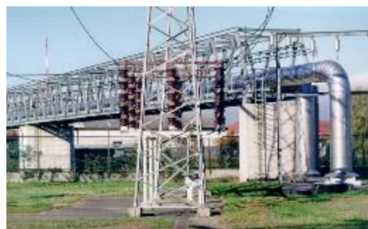
Tubazioni teleriscaldamento in uscita dalla Centrale.
