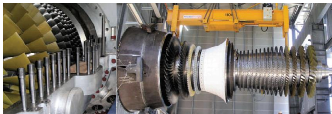
Turbina a gas ciclo combinato RPW 2°GT
