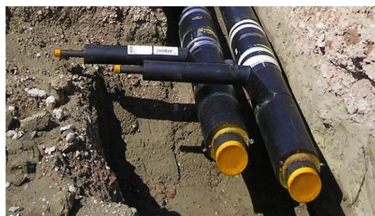
Tubazioni preisolate di teleriscaldamento.
