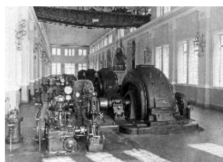
Sala macchine Centrale Rosone - 1930
